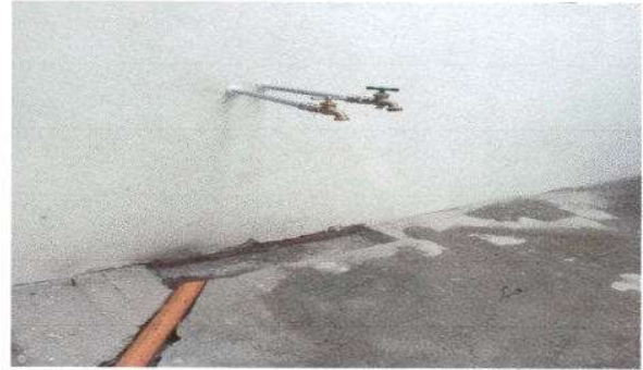
Foto 16: Sustrucción de pila de cemento de 2 lavaderos en cocina.
