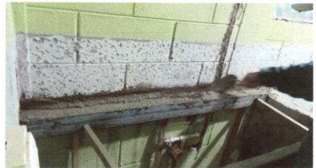
Foto 18: Sustrucción de lavatrastos en cocina.
